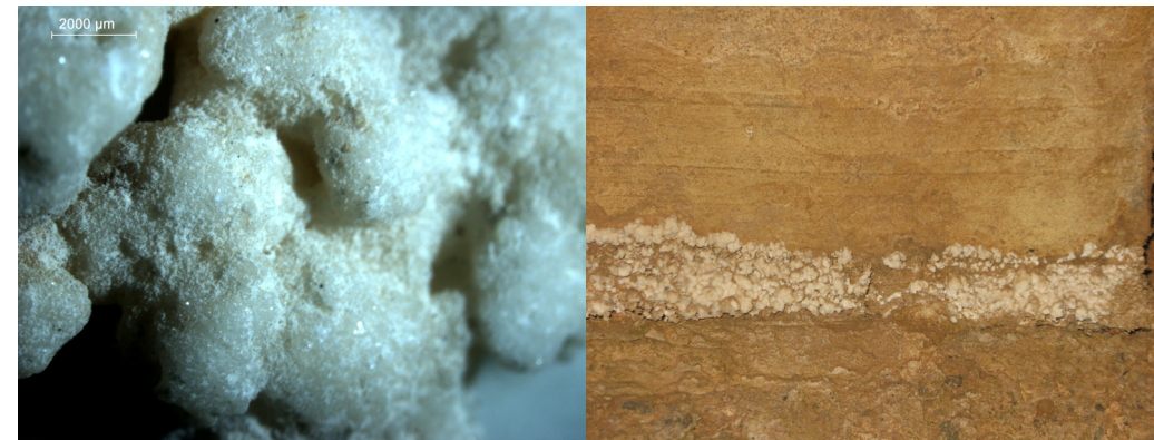
Recristal·lització de sals, segurament sulfat de calci. Especialment present en l'arrancada de la volta. En el detall d'un fragment de sulfat de calci, extret de les sals precipitades, observem, a manera d'estalactita, una presència contínua d'humitat provocada per un degoteig lent i prolongat que deriva en la formació de sals insolubles.
